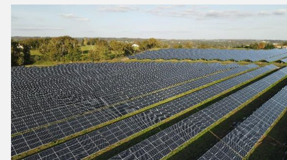
Centrale Solaire d'EXIDEUIL Département : Charente (16) Puissance électrique : 9600 kWc Mise en service : Décembre 2020
